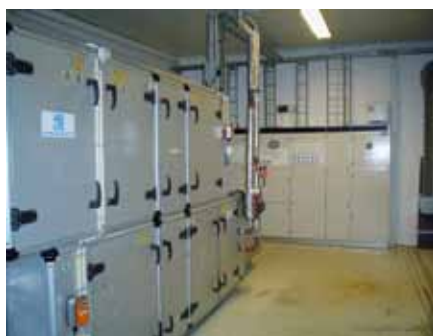
Bildet viser oversiktlig ventilasjonsrom som er på bakkenivå med stor dør og med god plass for servicevedlikehold.
