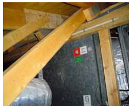
Bildet viser et ventilasjonsaggregat som er montert på et kaldloft, takstol konstruksjonen er bygd rundt anlegget.
